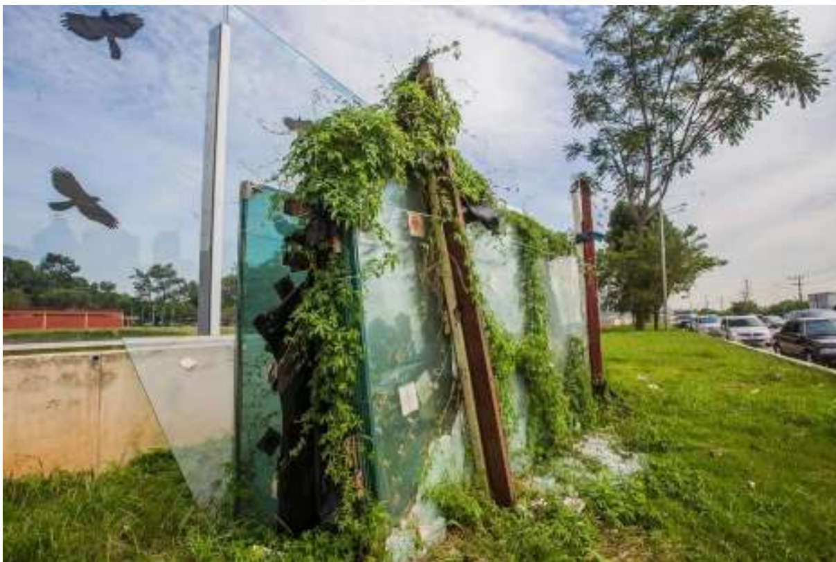
Painéis dispostos próximos ao muro estão abandonados; 17 continuam quebrados Foto: TIAGO QUEIROZ/ESTADÃO
